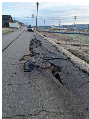
▲地震により被災した道路 (中能登町提供)
