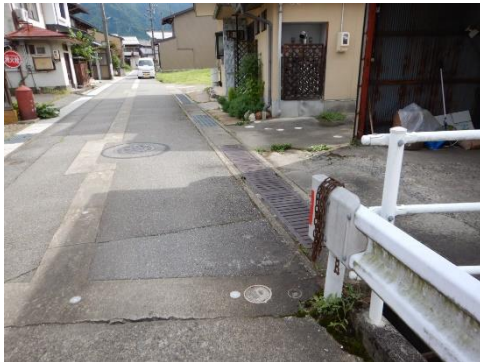
▲老朽化した側溝 (整備前)
