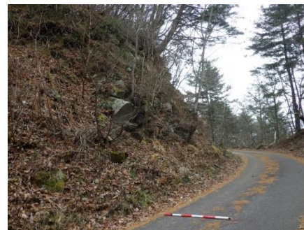
▲崩落の恐れがある法面 (安峰線)
