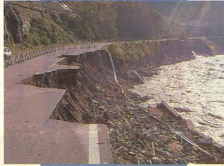
▲国道360号線決壊（宮川町）
