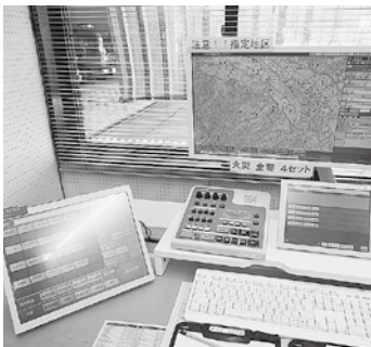
消防・救急デジタル無線指令システム操作卓
