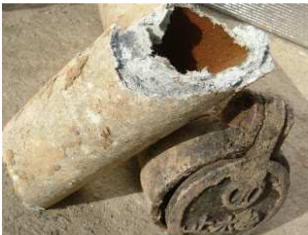
破損した石綿管 (イメージ)
